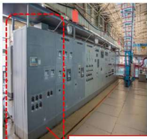
工場内配電盤
