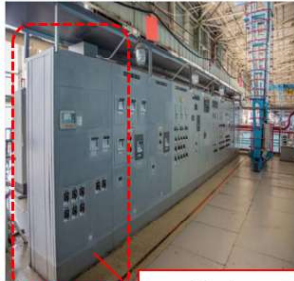
工場内配電盤
