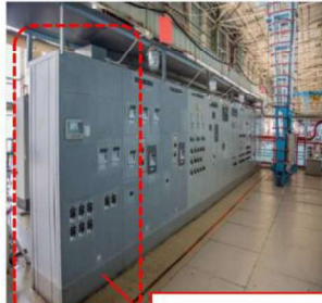
工場内配電盤
